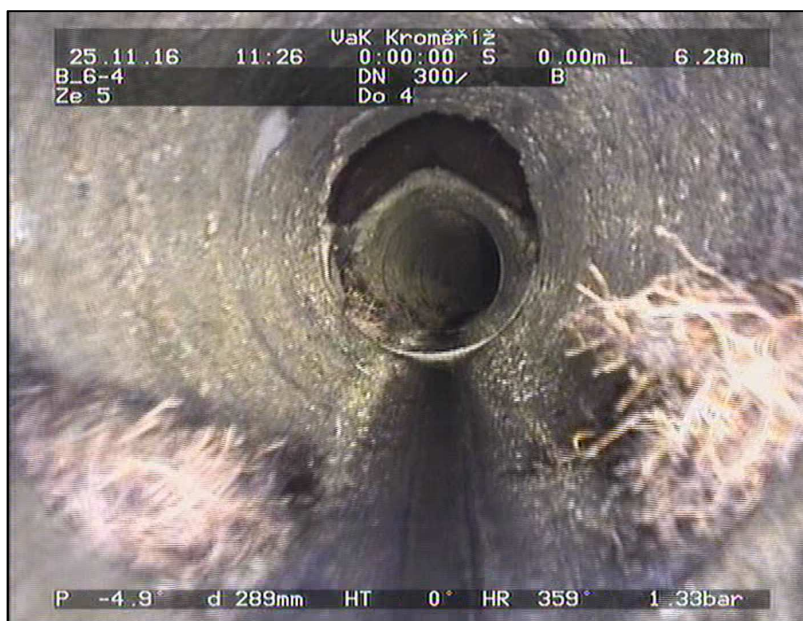
Obr.č. 3 – Stoka B - destrukce potrubí a vrůstání kořenů
