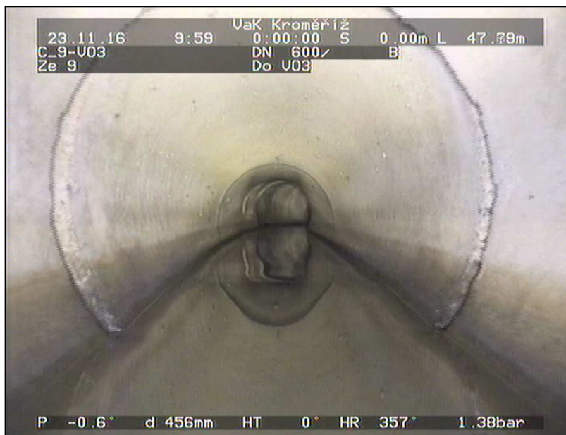
Obr.č. 4 – Stoka C - vzduší odpadních vod v úseku v protisklonu
