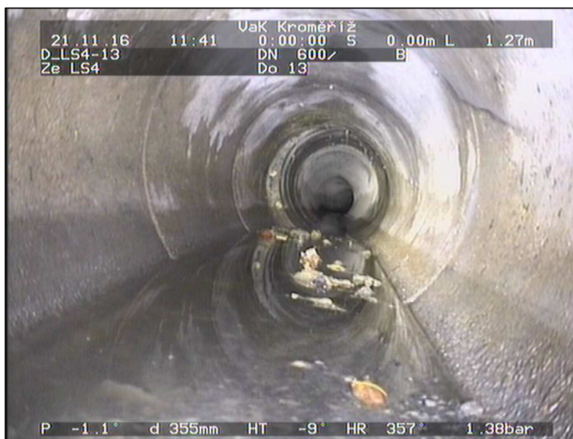
Obr.č. 5 – Stoka D - vyhnutí potrubí v zámku, sediment
